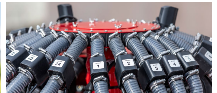
Überwachung des Pneumatikdurchflusses am Verteilerturm
