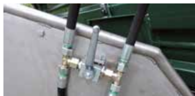
Abschaltung über Bypass
