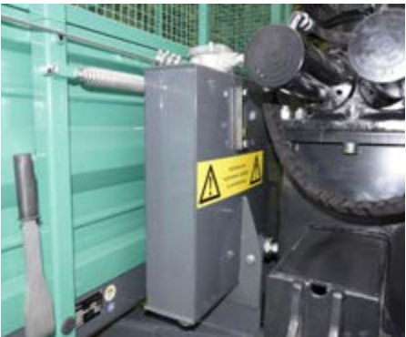
Tank eigene Ölversorgung
