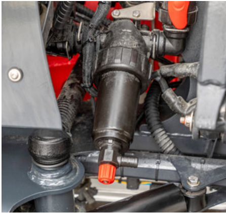
Deuxième filtre de pression dans le cadre central de la rampe
